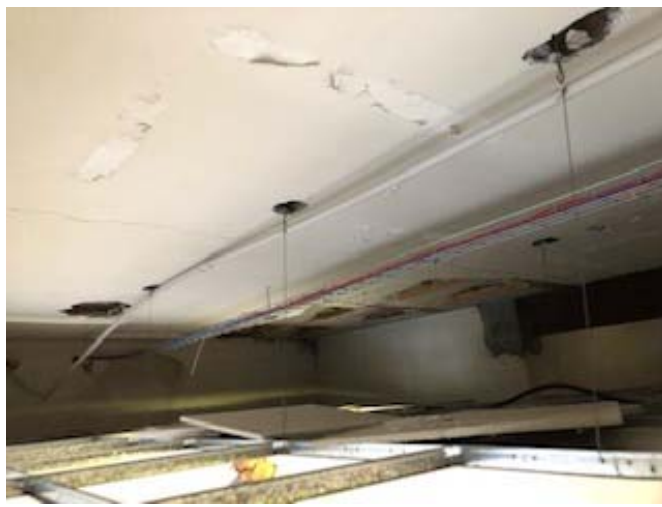
Piano terra – solaio ammalorato ingresso
