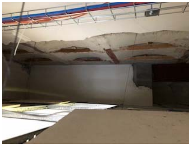
Piano terra – solaio ammalorato ingresso
