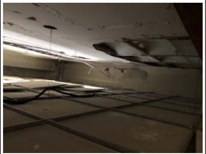
Piano terra – solaio ammalorato ingresso
