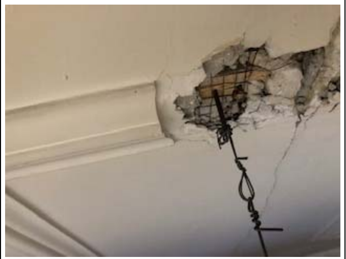
Piano terra – solaio ammalorato ingresso
